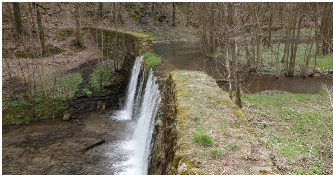
Rys. 7. Zapora przeciwrumowiskowa na potoku Żarnówka Duża – ochrona zbiornika Porąbka (fot. A. Jaguś).
