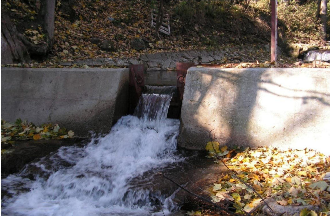
Rys. 2. Stopień pomiarowy w korycie potoku Czarna Woda (fot. A. Jaguś). Fig. 2. Measurement dam on the Czarna Woda stream (photo by A. Jaguś).
